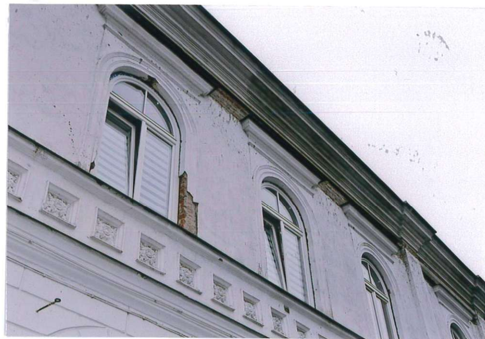
Fot. 3. Elewacja frontowa. Zniszczenia w obrębie piętra.
